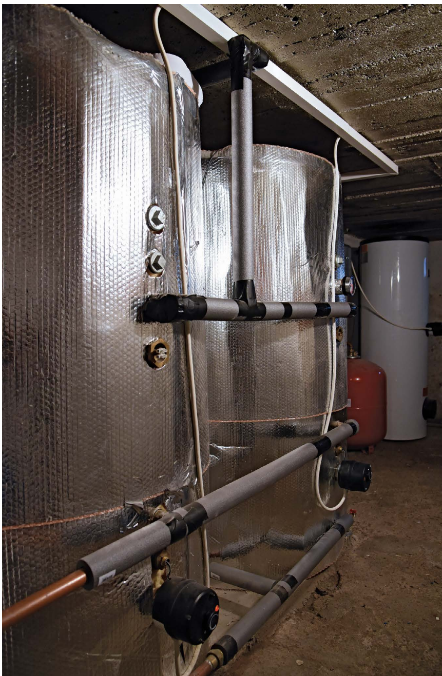
Akumulační nádrže s vodou pro otopnou soustavu chráněné reflexní izolací
